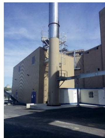
Figure 2 : Chaudière Vyncke sur le site de Boortmalt (Issoudun, France)
